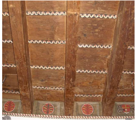
Nel corso dell'anno 2009, è stato restaurato il soffitto in legno risalente alla fine del 1500, recuperando gli antichi decori.
